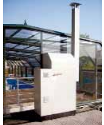
Instalación en piscina cubierta
