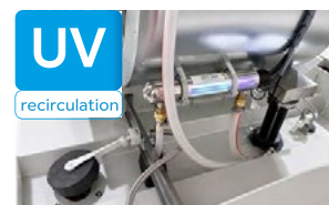
Tratamiento de agua mediante UV
