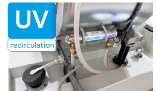
Tratamiento de agua mediante UV
