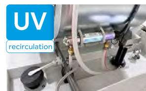
Tratamiento de agua mediante UV
