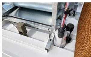
Bomba de agua, vaciado eléctrico y sensor de nivel
