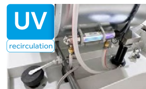
Tratamiento de agua mediante UV
